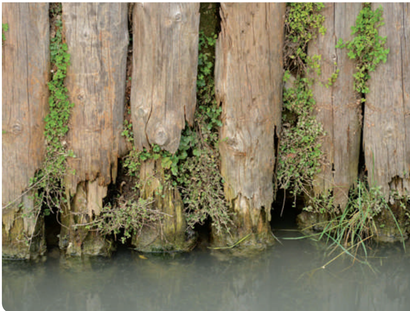
La palizzata che "dovrebbe" contenere il terrapieno. Minata e incontenuta in diversi punti
